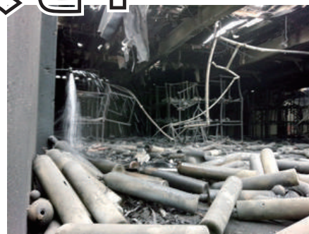
散乱し建物の外まで飛んだボンベ！
